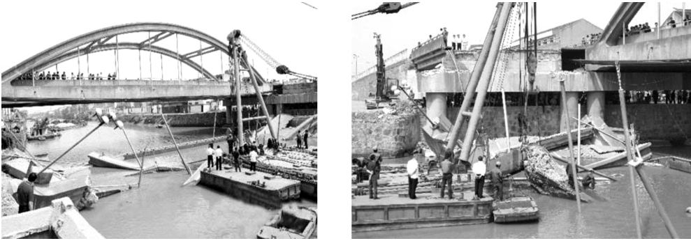
图 1-1 江苏常州运河大桥倒塌现场照片(来自互联网)
