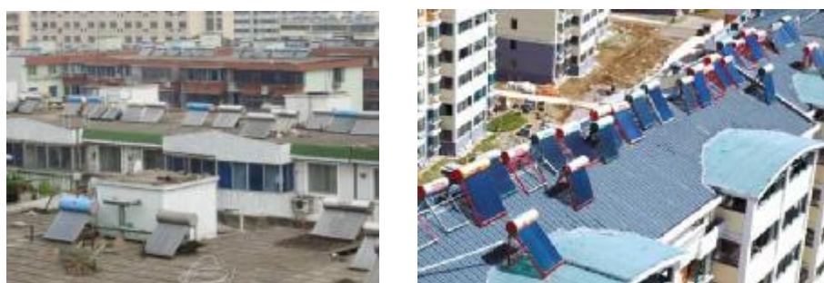
图 1-4 集热器安装混乱
