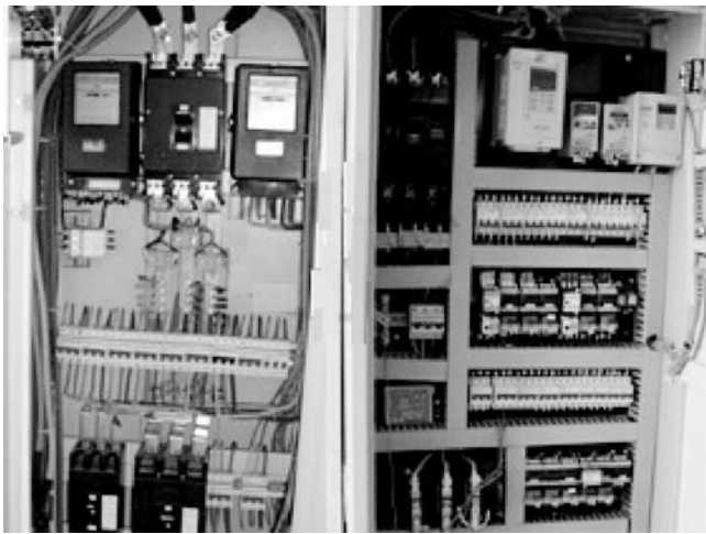
图 1-1 电气控制系统实物图
