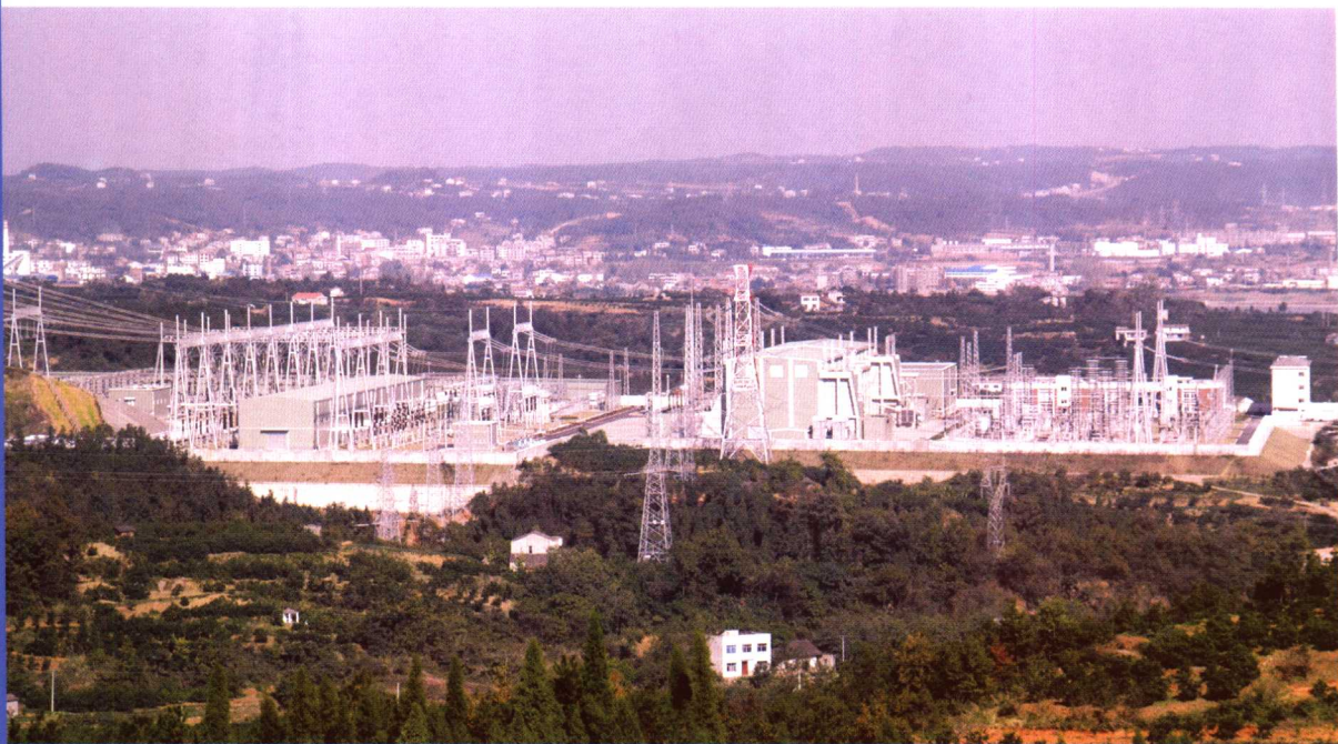
宜都换流站全景
