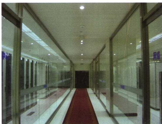
图 9-21 改建后的机房
