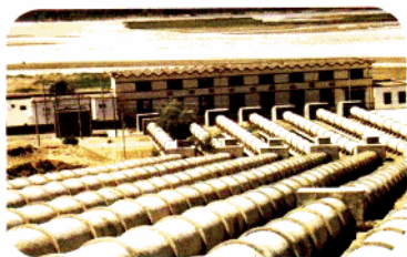
固海扬水工程泉眼山泵站
