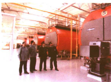
某部燃煤锅炉改用清洁能源
