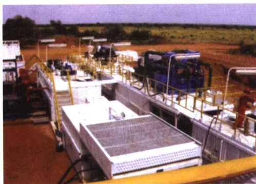
泥浆罐区一角
