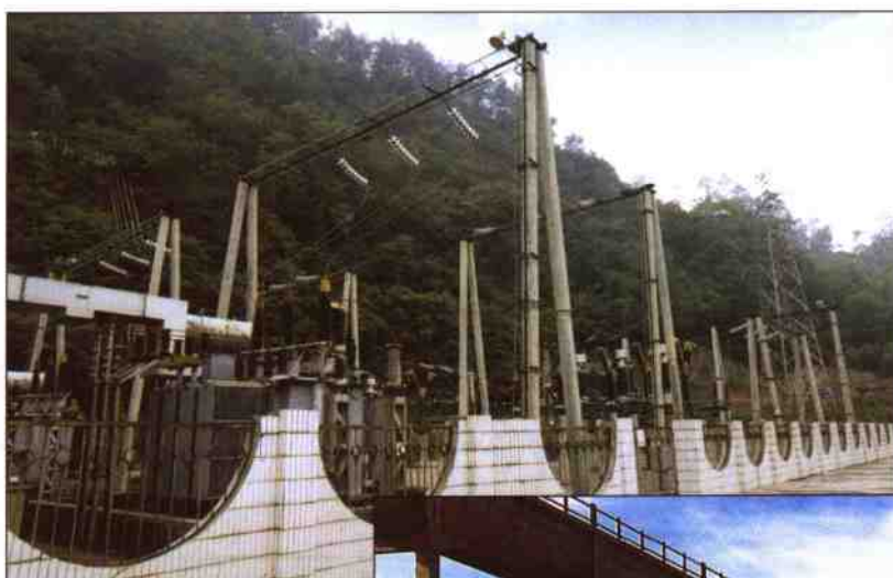
东雷抽黄续建工程 110kV变电站
