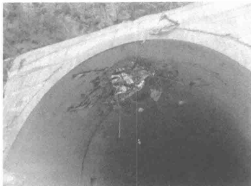
图 1.1.3 耿达隧道洞口段明洞被砸穿
