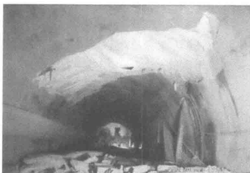
图 1.1.6 龙溪隧道左洞进口拱部二次衬砌垮塌
