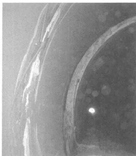
图 1.1.4 白云顶隧道洞口段衬砌环向错台
