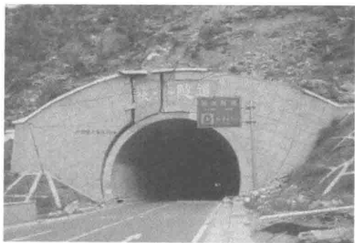
图 1.1.5 桃关隧道洞门端墙断裂、拱圈损坏
