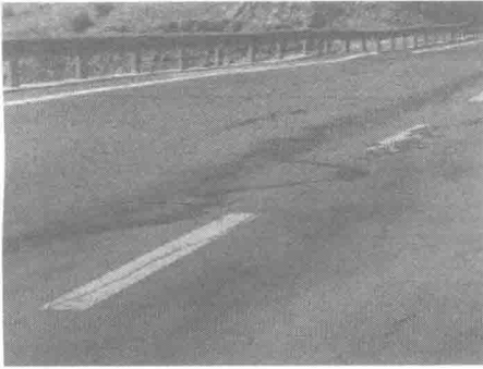
图 2.1 路基纵向不匀沉降示例图
