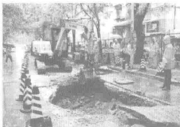
(a) 北京市西城区里仁街塌陷
