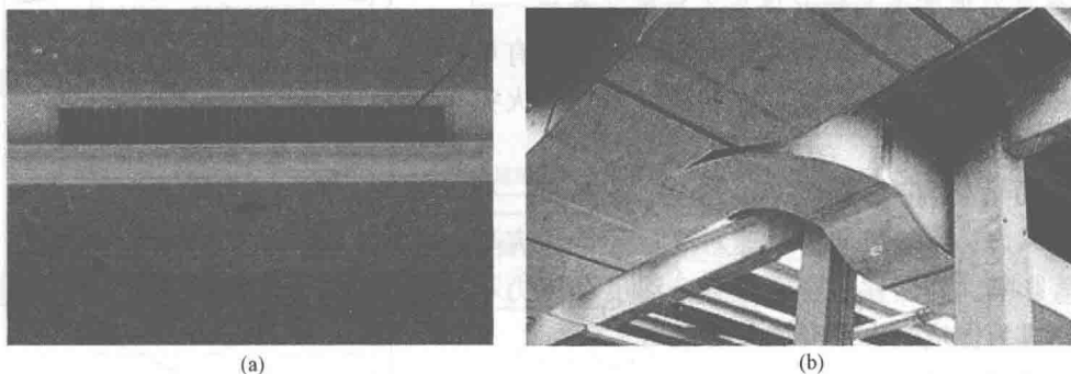
图 1-3 火情通过空调系统的风道和管道蔓延
