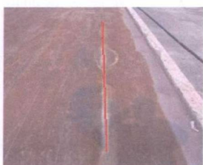
e) 钢箱梁桥面板疲劳开裂
