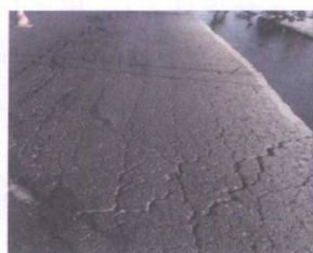
f) 钢桥面铺装破损
