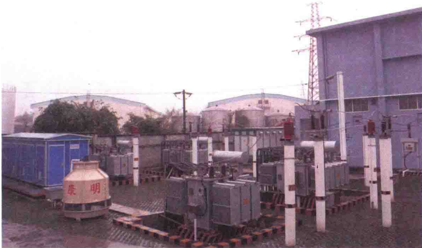
图 1-6 眉山牵引变电所同相供电装置
