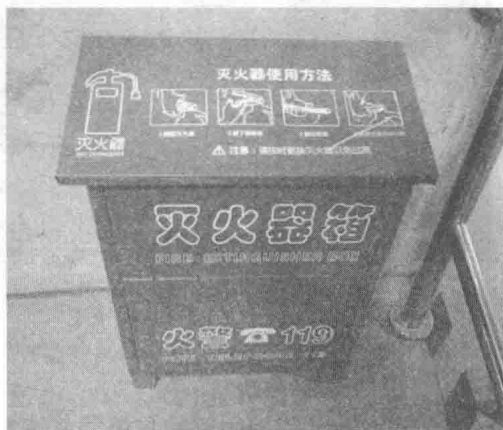
图 1.1-14 管廊内手提式灭火器
