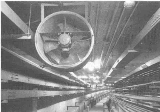
图 1.1-17 管廊内通风系统
