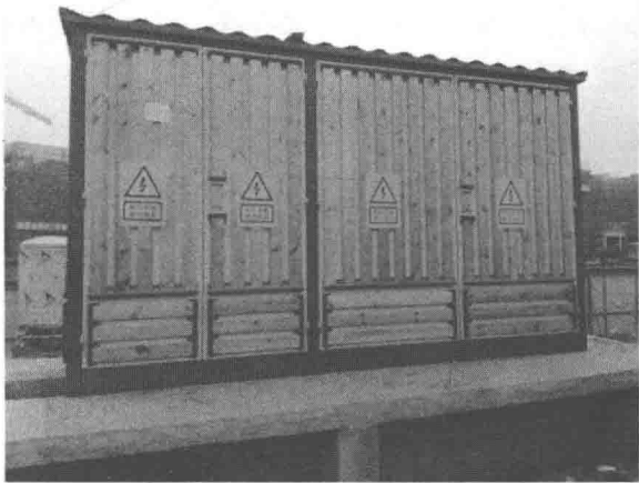
图 1.1-12 管廊沿线箱式变电站
