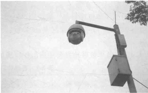
图 2-4 嘉陵江大桥、曹家沟隧道、米汤沟大桥等重点工程现场安装远程监控系统
