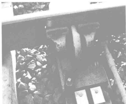
(a) 尖轨尖端处电务枕
