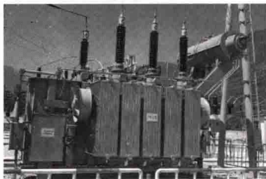
图 1-1 运行中的电力变压器
