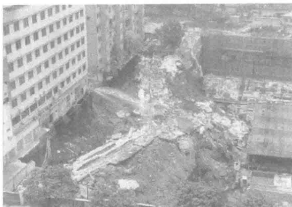
图 1-7 广州地铁海珠广场站基坑塌方
