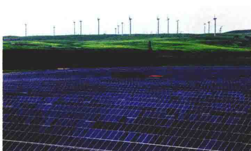
张家口坝上国家风光储输示范基地
