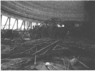
图 1.1-3 江西丰城电厂滑模垮塌事故
