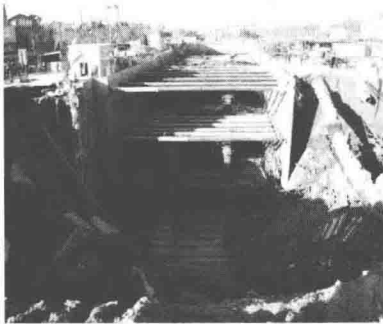
图 1.1-5 北京地铁基坑坍塌事故
