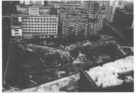
图 1.1-6 广州建筑基坑坍塌事故
