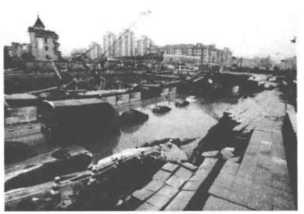
图 1.1-4 杭州地铁基坑坍塌事故
