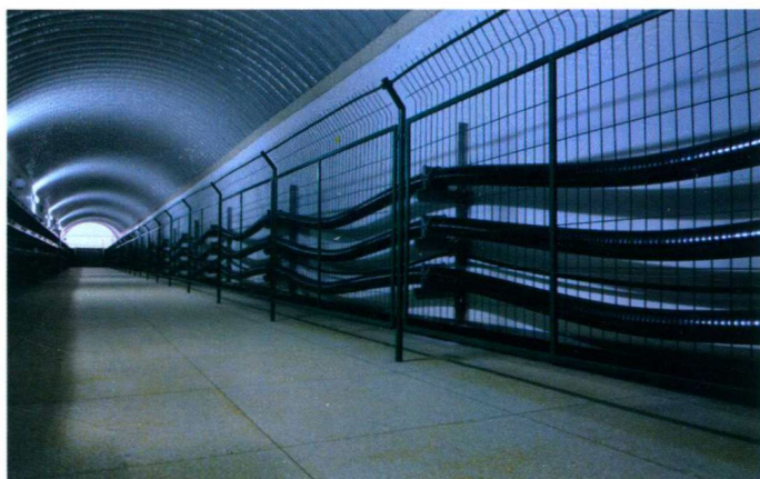
三板溪水电站输电线
