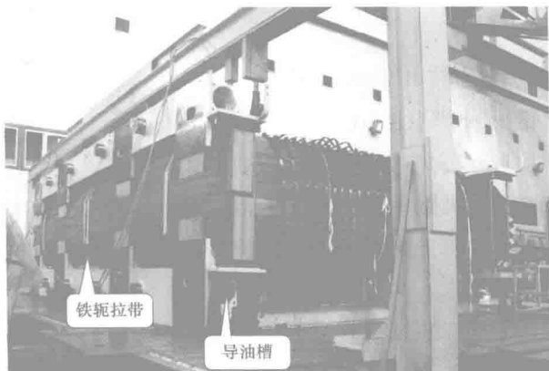
图 1-8 铁轭拉带和导油槽
