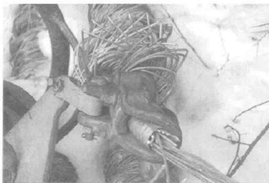
图 1-2 不均匀覆冰引起的线夹处导线损坏
