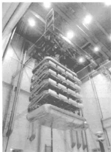
图 1-4 ±800kV、4000A 双重阀阀塔
