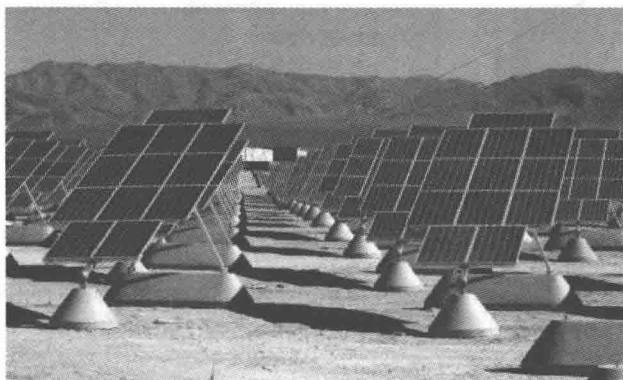
图 1.6 大型光伏并网发电站
