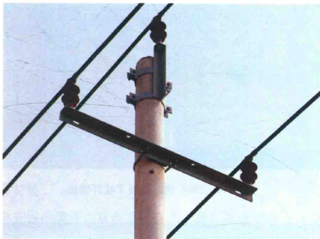
图 1-12 10kV 线路直线杆横担
