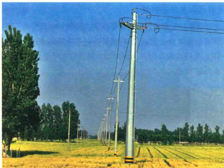
图 1-10 10kV 线路杆塔位移及偏差
