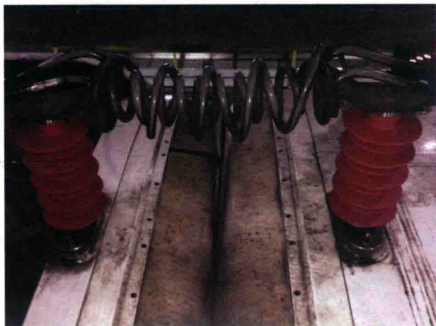
车顶高压跳线支撑绝缘子
