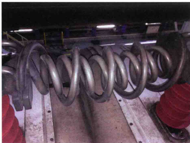
车顶高压跳线
