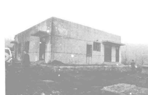
f) 岩后隧道洞口变电所损毁情况
