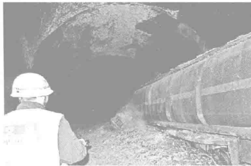
c) 七道梁火灾后隧道设施受损情况
