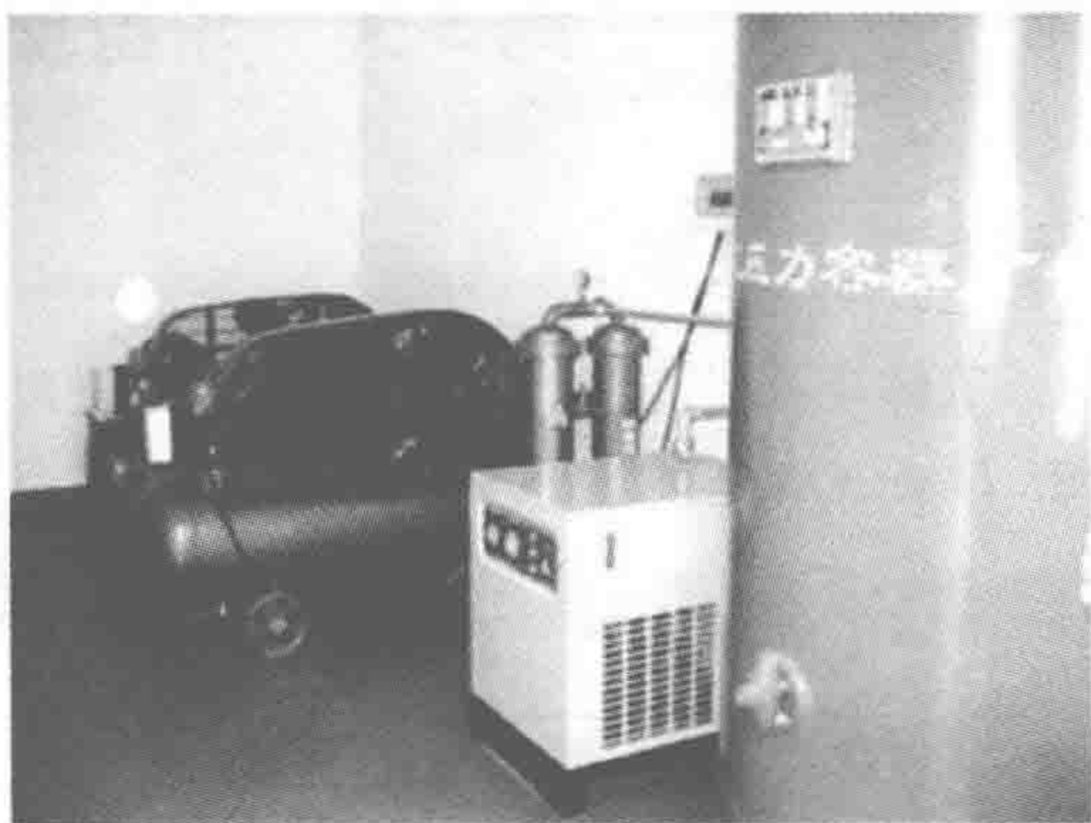
图 1-14 空气压缩机房
