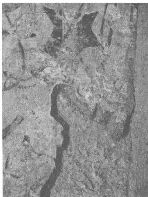
图6 主室正壁左侧空鼓壁画修复后
