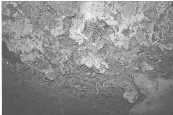
图9 主室佛龛正壁酥碱壁画加固前
