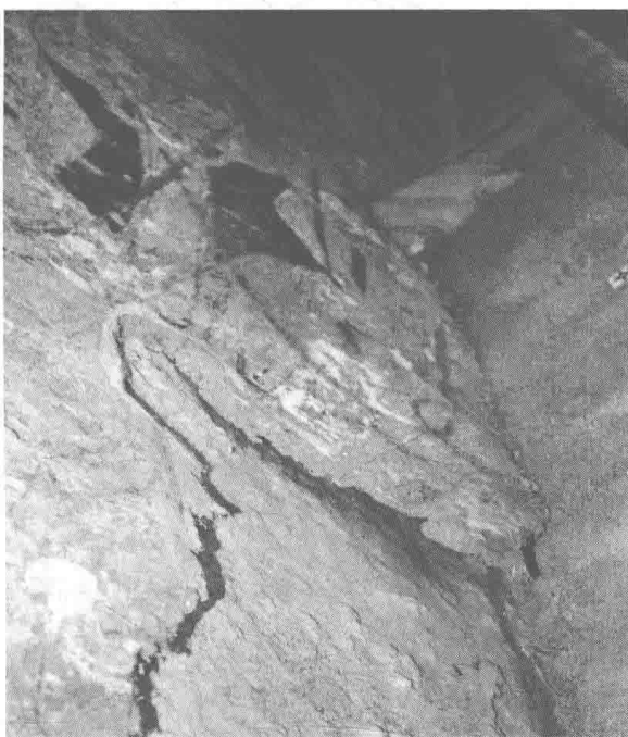
图5 主室正壁左侧空鼓壁画修复前
