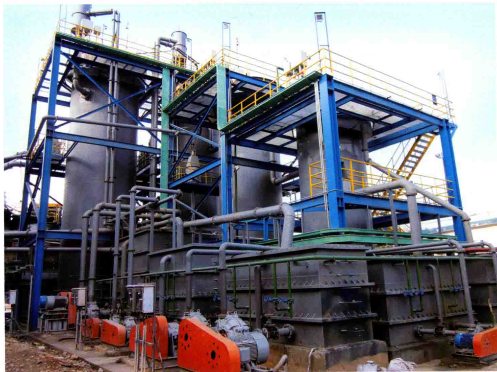
江西铜业德兴铜矿泗洲选厂 KYZ-4315/3612/3009 浮选柱使用现场
