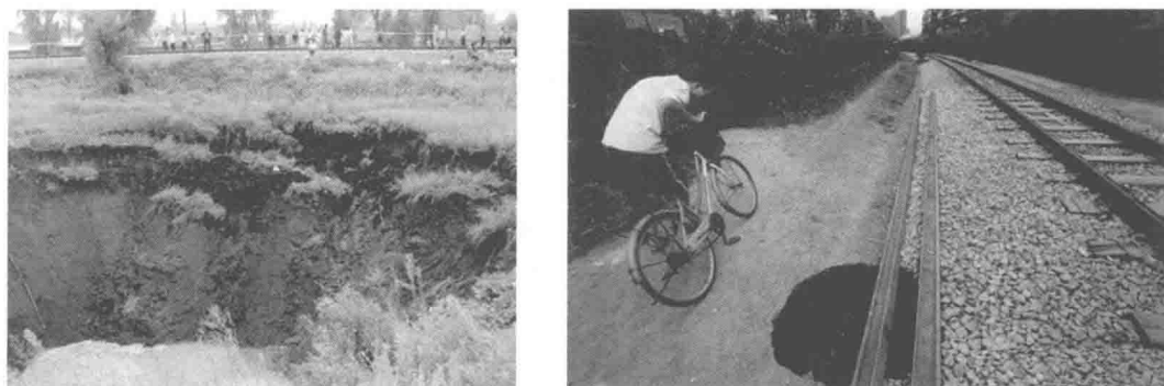
图1.1 铁路附近采空区塌陷
