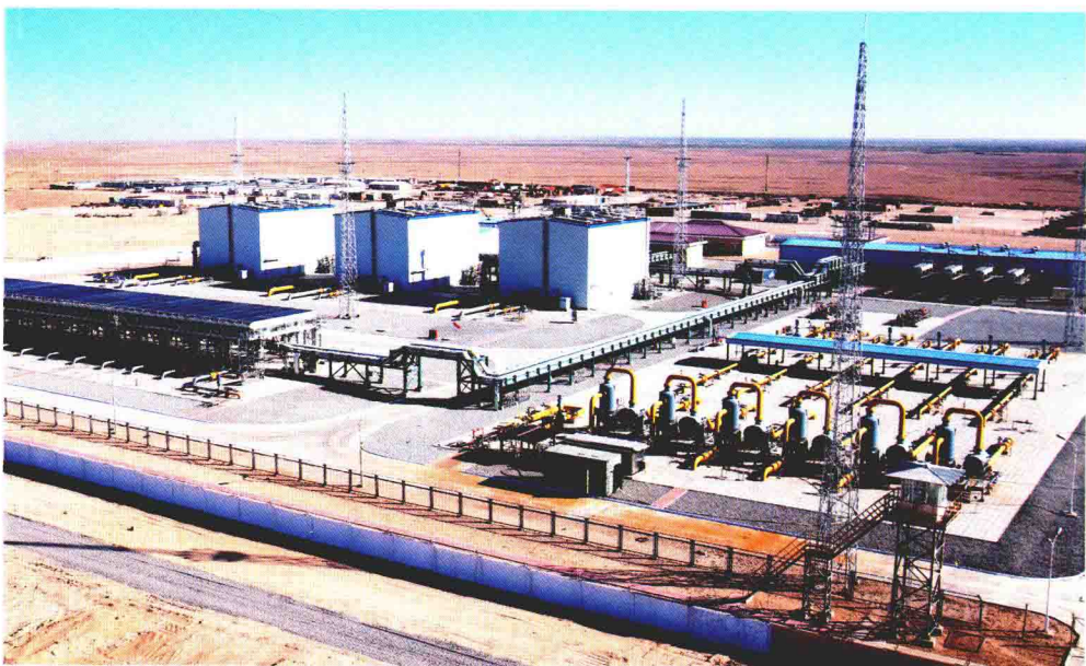
中国石油工程建设公司承担了中亚管道大部分压气站项目的建设，图为由公司自主设计的乌兹别克斯坦 UCS1 压气站全景
