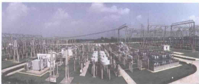
图 1-1 500kV 常规变电站
