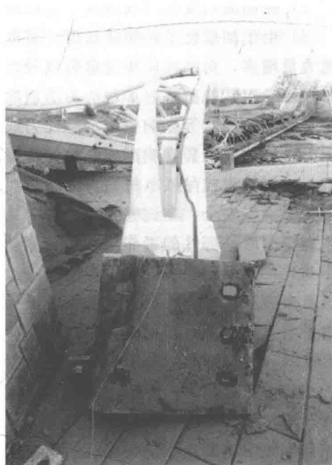
图 1.3-2 试验桥梁垮塌
