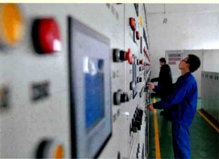
彬长集团装机总容量1.3万千瓦的低浓度瓦斯发电厂和煤矿通风瓦斯（乏风）氧化发电项目 (李军朝 摄)
