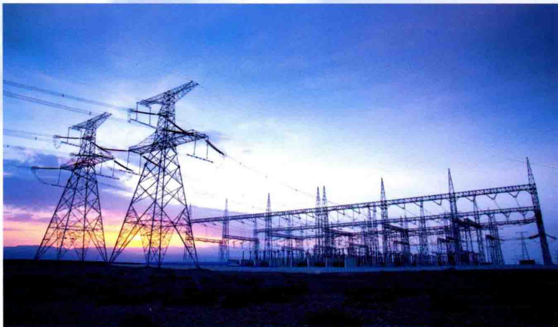
2010年,在巴里坤三塘湖建成220千伏变电站
