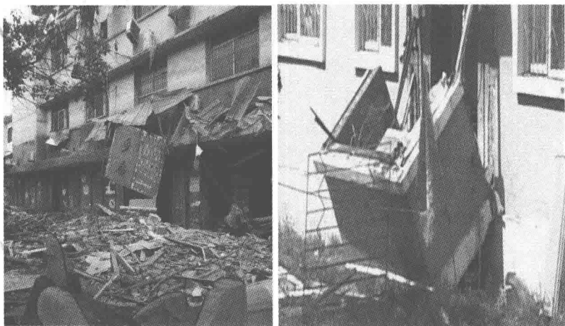
图1 坍塌的老旧建筑
