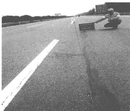
图 1.1 差异沉降导致的路面反射裂缝
