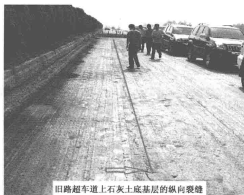
图 1.2 旧路底基层的纵向裂缝
