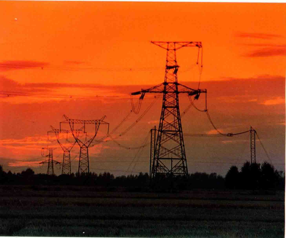
2 万伏输变电路
