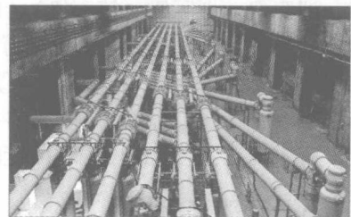
图 2.3 水电站的高压气体绝缘开关设备 (由 ABB Switzerland 授权提供)
