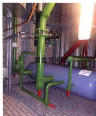
图 12 在高压贮液器出液管上的紧急关闭阀（Diepop's-Hertogenbosch B. V，欧洲）
