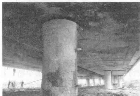
图 1-9 福宁高速公路宁德大桥火灾
