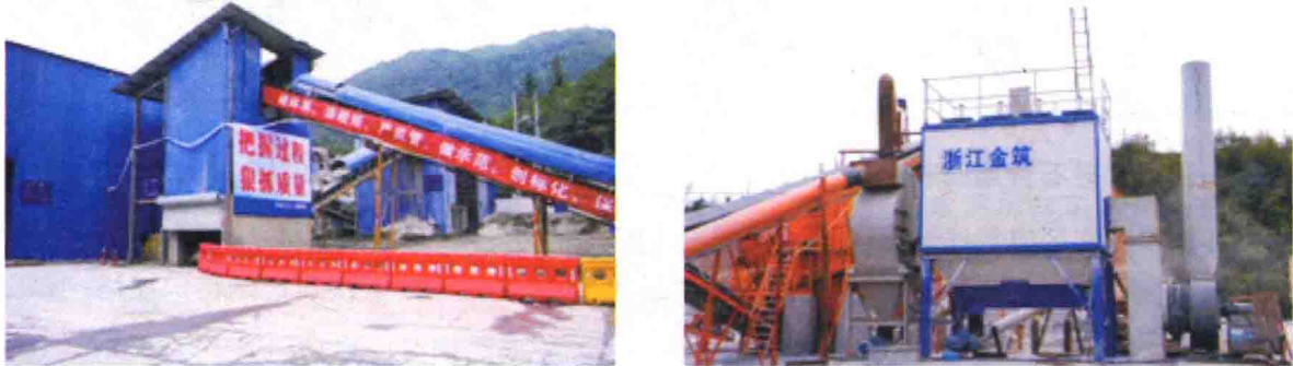
图 19 设备外包封闭及布袋除尘器实例
