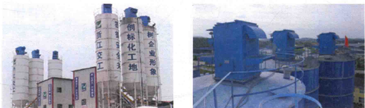
图 14 水泥罐除尘装置实例
