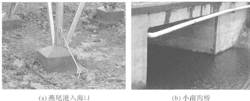
图 1-8 灌云县基础混凝土调查
