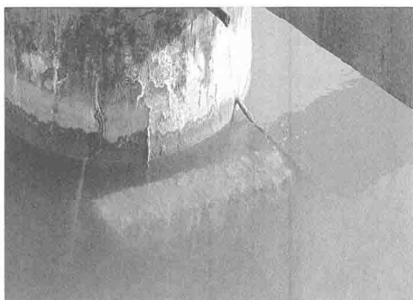
(b) 水位变动区的环氧包裹层破裂
