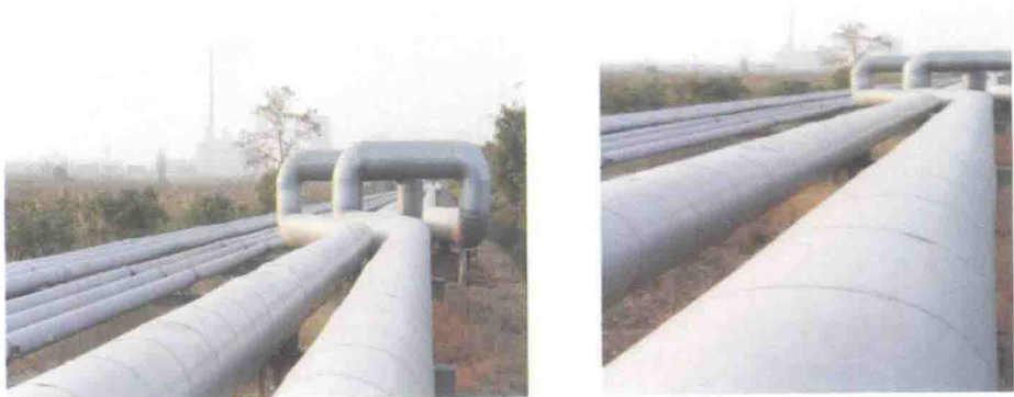
常熟金陵海虞热电厂供热管网
