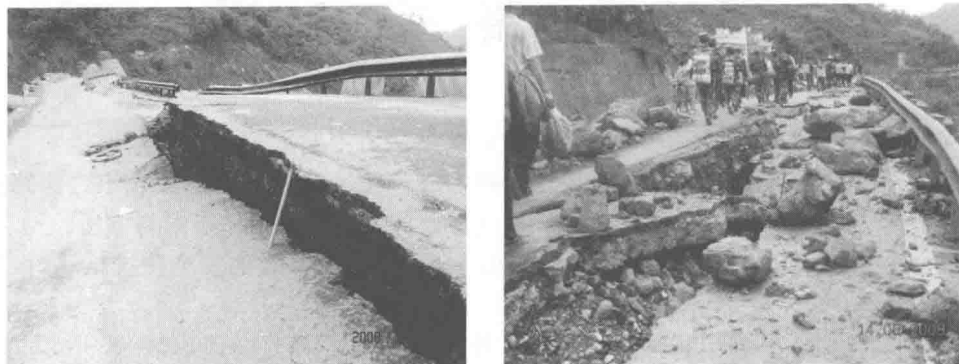
图 2-2 路基沉陷形成错台路段
