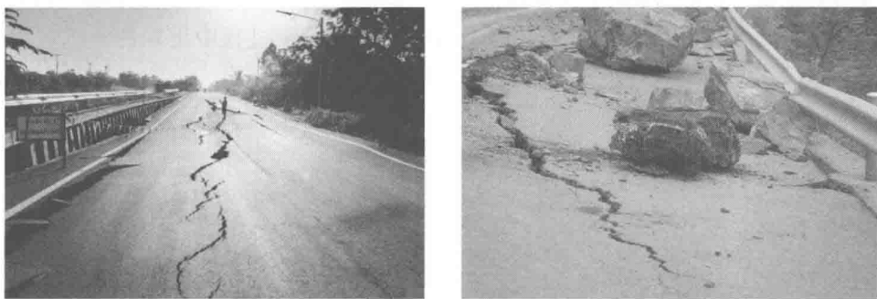
图 2-1 路基沉陷开裂路段
