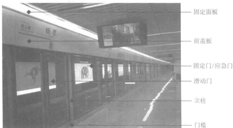
图 2-1 屏蔽门系统工程外观实景
