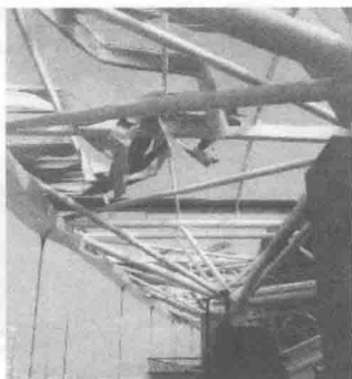
图 1-4 某体育场屋盖受风灾破坏情况
